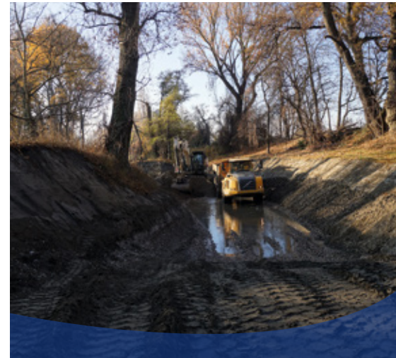
▲ La lône des Dames pendant les travaux de restauration en novembre 2017 CEN Isère
